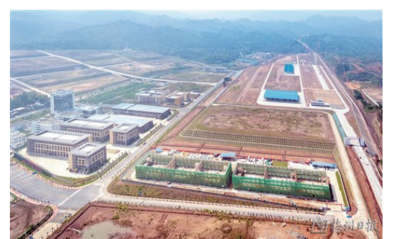
梅州綜合保稅區二期項目和梅州國際無水港項目正在加快建設中。(連志城 攝) (梅州僑聯供稿)
